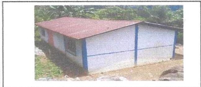
Foto1: Necesidad de Rehabilitar aula multigrado nivel primario
