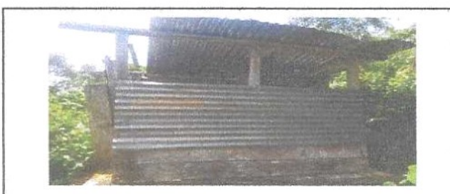
Foto 6: Los sanitarios estan en mal estado.
