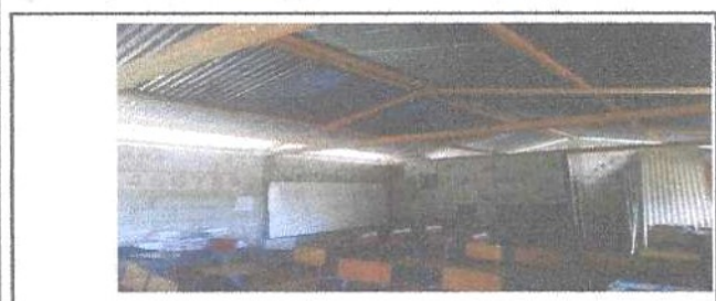
Foto 3: Las vigas de madera ya presentan deterioro.
