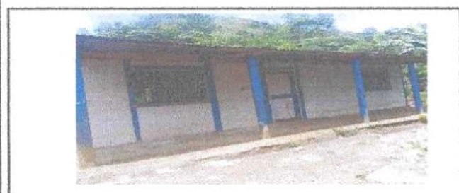
Foto 5: Corredor de escuela en mal estado.
